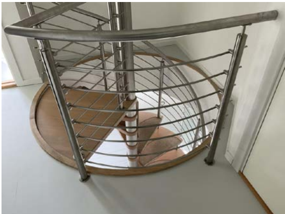
Vindel-trapp og rekkverk tilfredsstillende ikke sikkerhetskrav.
