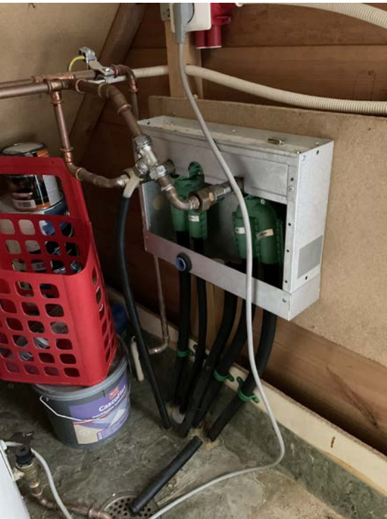
Fordelerskap plassert på loft.
