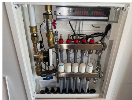
Fordelerskap vannbåren gulvvarme
