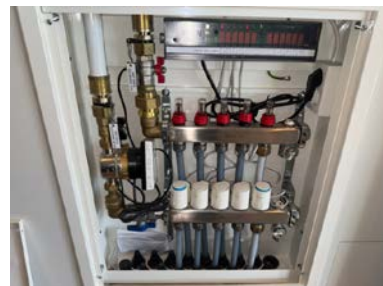
Fordelerskap vannbåren gulvvarme
