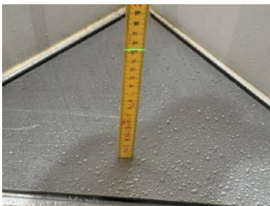
Fallforhold ca. 153 mm topp slukrist i dusjsone
