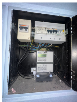
Sikringsskap med automatsikringer.
