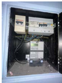
Sikringskap med automatsikringer.
