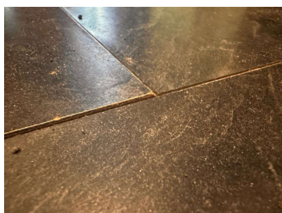
Svelling i laminatgulv i entré
