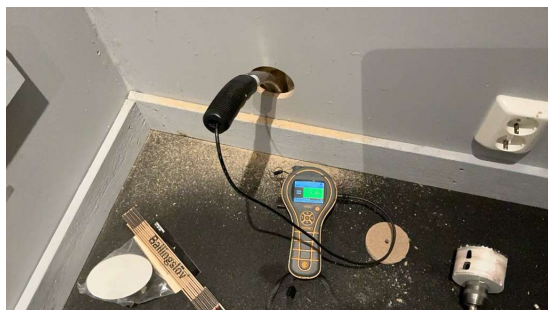
Måling i yttervegg på treningsrom
