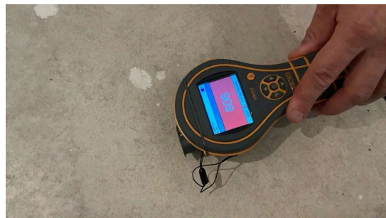
Fuktutslag gulv treningsrom.
