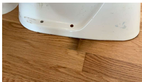
Noe tørket fuktskjold med toalett
