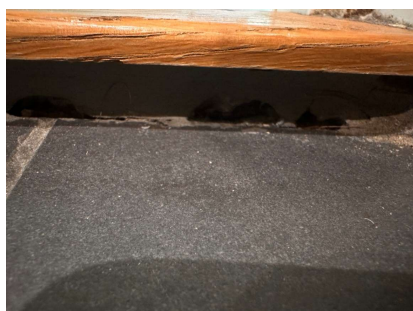
Hull i silikonfuge under dørteskel
