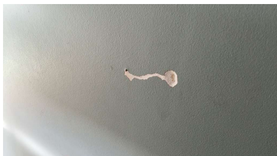
Eksempel på hakk i vegg
