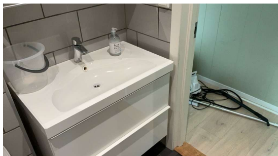
Bildet viser at døren er i våtsonen av vasken.
