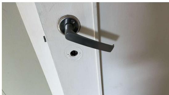
Dørvrider henger, samt lokk ved nøkkelhull mangler
