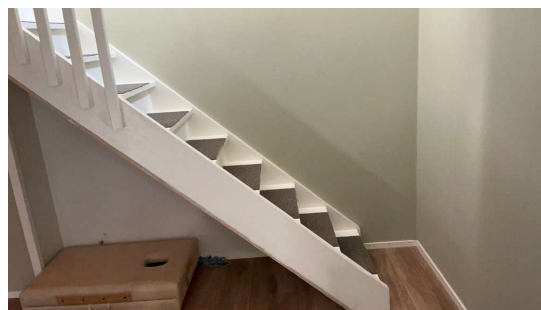
Mangler rekkverk i trapp
