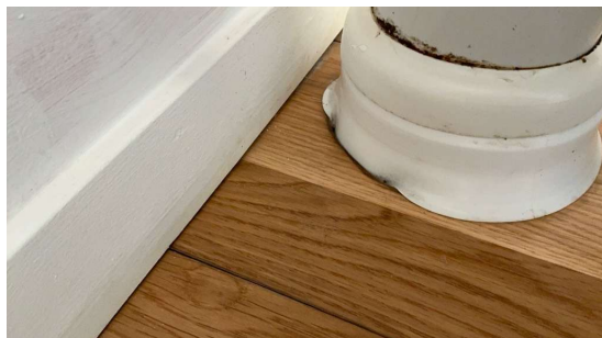
Noe tørket fuktskjold med toalettavløp
