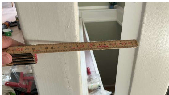
Et par steder er det registrert at åpningen i rekkverket overstiger 10 cm.
