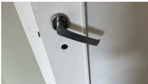
Dørridder henger, samt lokk ved nøkkelhull mangler
