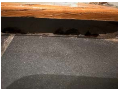
Hull i silikonfuge under dørteskel
