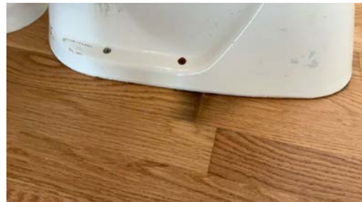
Noe tørket fuktskjold med toalett
