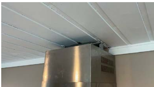
Viftekapen går ikke helt opp til taket.
