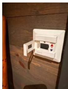
Termostat i tv-stue som ikke virker.
