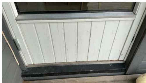
Balkongdøren har værslitasje i form av oppsprukket maling
