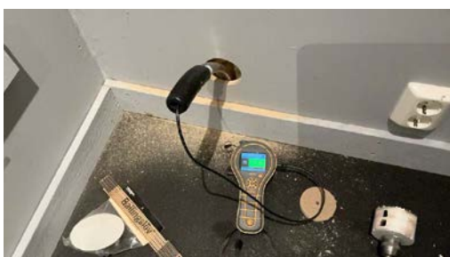
Måling i yttervegg på treningsrom
