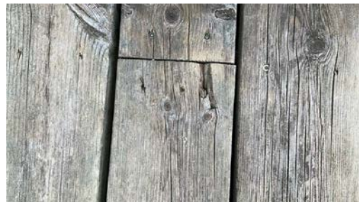
Eksempel på sprekk i terrassebordene
