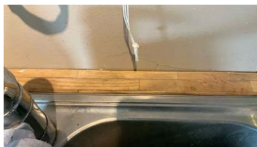
Manglende silikon-/fugemasse mellom benkeplate og vegg, samt mindre skader på veggflaten like over benkeplaten.
