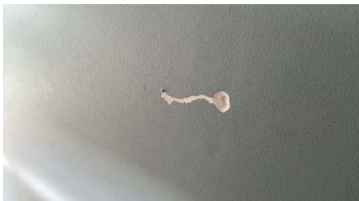
Eksempel på hakk i vegg
