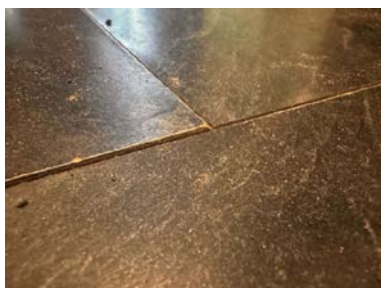
Svelling i laminatgulv i entré
