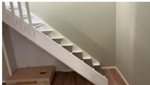
Mangler rekkverk i trapp
