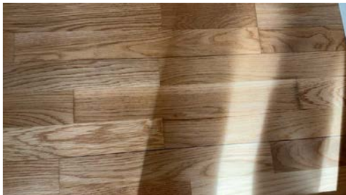
Noe åpning i parkettskjøt
