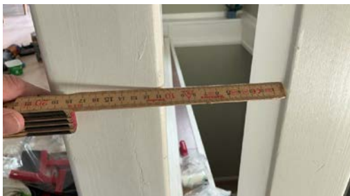
Et par steder er det registrert at åpningen i rekkverket overstiger 10 cm.
