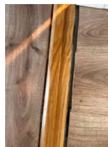
Eksempel på manglende lister ved dørtreskel
