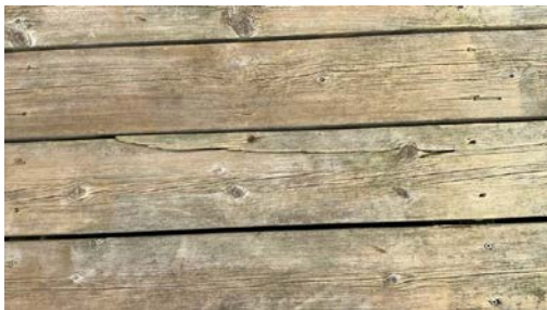
Eksempel på sprekk i terrassebordene
