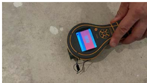
Fuktutslag gulv treningsrom.
