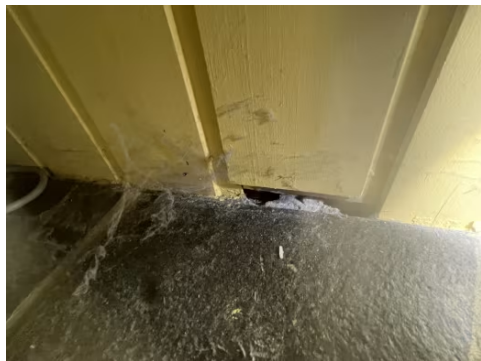
Synlige åpninger i overgang vegg/ gulv.
