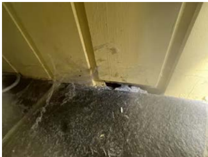
Synlige åpninger i overgang vegg/ gulv.
