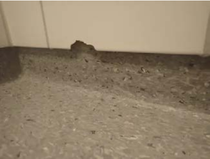
Sprekk/skade i veggflis.
