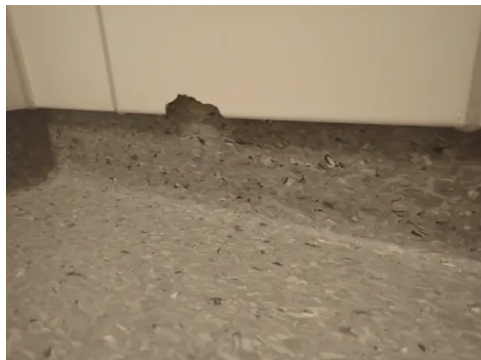
Sprekk/skade i veggflis.
