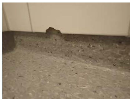
Sprekk/skade i veggflis.
