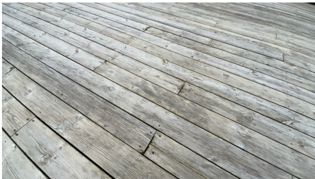
Råte i enkelte skjøter til terrassebord.
