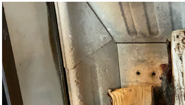
Sprekker i ildfast stein i ovn.
