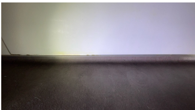
Det er ikke tilstrekkelig fuget i overgang mellom plater og bunnlist som platene er montert på.
