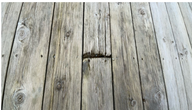
Råte i skjøt til terrassebord.
