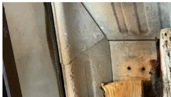
Sprekker i ildfast stein i ovn.
