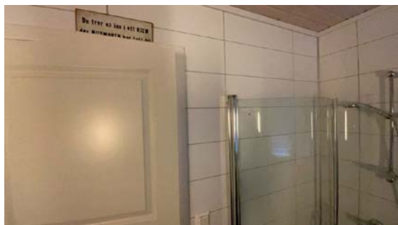
Innvendig dør i våtsone for dusjnise.
