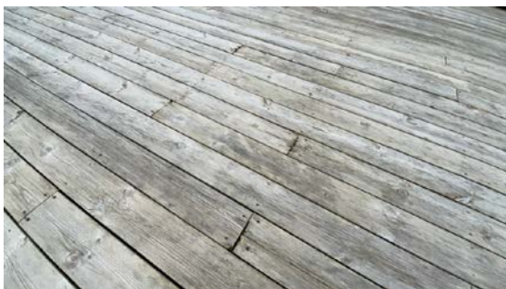
Råte i enkelte skjøter til terrassebord.
