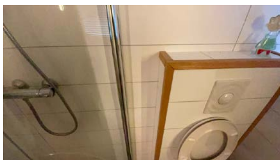
Trelister på toalettasse som er plassert i våtsone for dusjnise.
