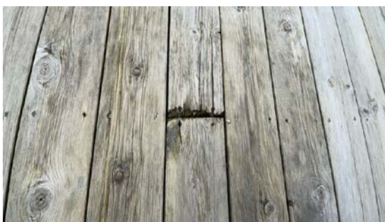
Råte i skjøt til terrassebord.
