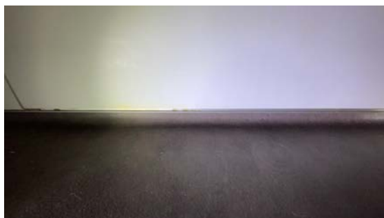
Det er ikke tilstrekkelig fuget i overgang mellom plater og bunnlister som platene er montert på.
