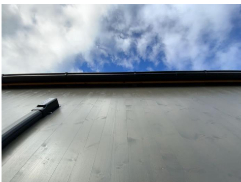
Synlige luftespalter i gesims.
