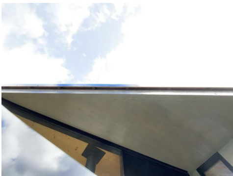
Synlige luftespalter i gesims.
