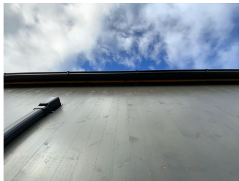
Synlige luftespalter i gesims.
