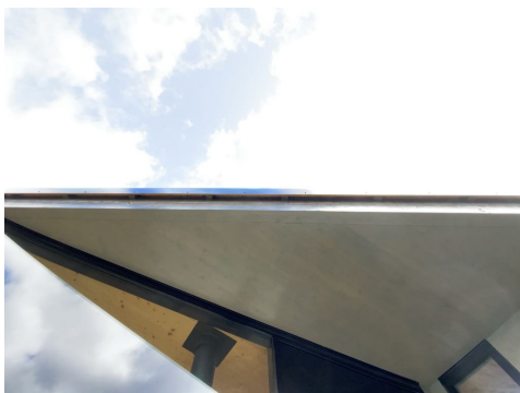
Synlige luftespalter i gesims.
