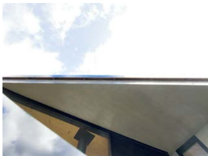
Synlige luftespalter i gesims.
