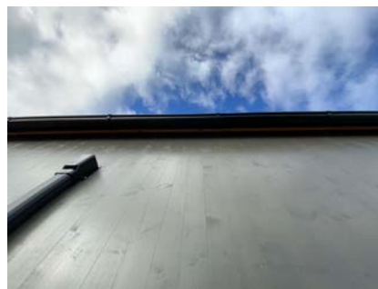
Synlige luftespalter i gesims.
