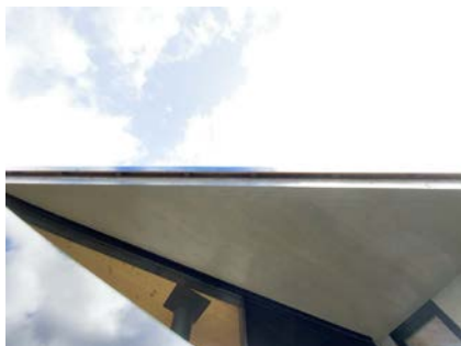
Synlige luftespalter i gesims.
