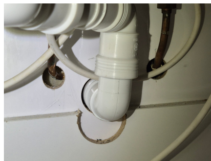
Ikke tette rørgjennomføringer under vask.
