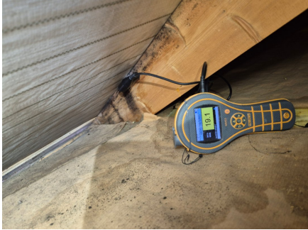
Målt høye fuktverdier i nedre del av konstruksjonen mot nord-øst.
