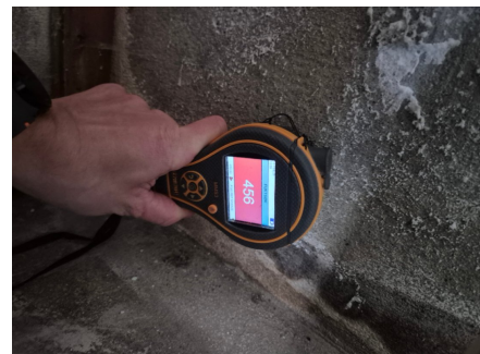
Indikert fukt i garasje.
