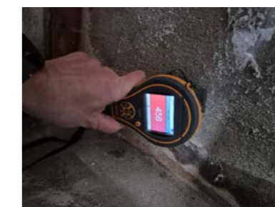
Indikert fukt i garasje.
