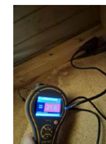
Målt høye fuktverdier rundt luftehatt over toalettrom.
