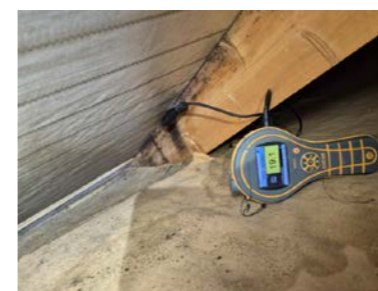
Målt høye fuktverdier i nedre del av konstruksjonen mot nord-øst.
