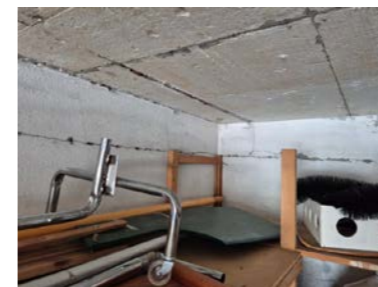
Sprekker i garasje.
