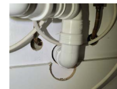
Ikke tette rørgjennomføringer under vask.
