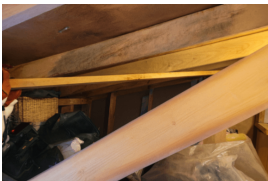
Noe misfarging på undertak og bjelke.
