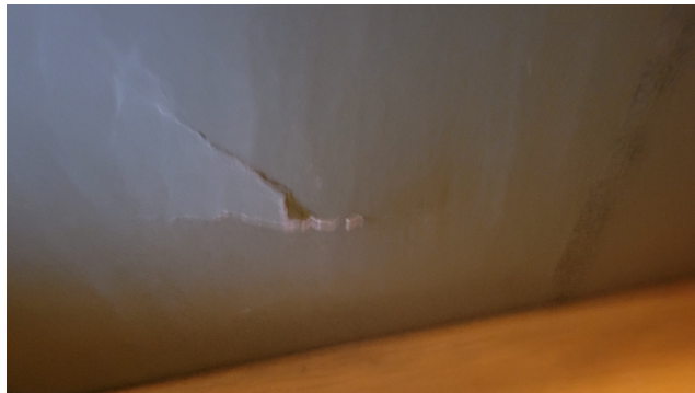
Mindre skade i undertak av gips.
