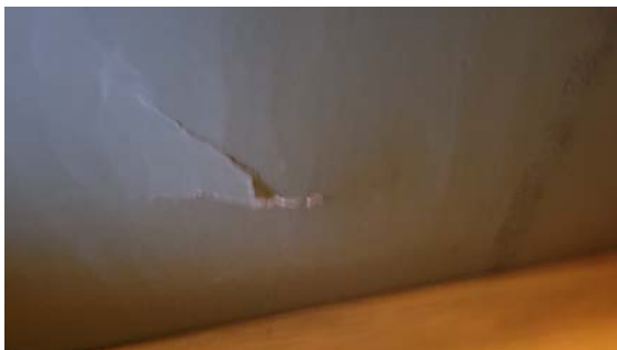
Mindre skade i undertak av gips.
