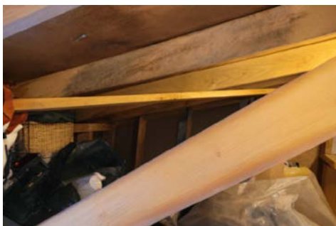
Noe misfarging på undertak og bjelke.
