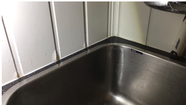
Fukt skader i plater ved vask
