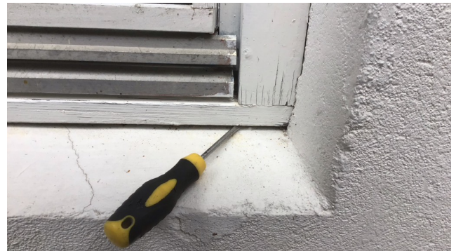
uttettheter rundt kjellervinduer
