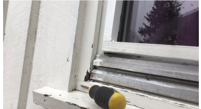
Fukt i vinduskarm
