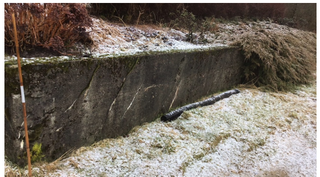
Sprekker/skader i mur
