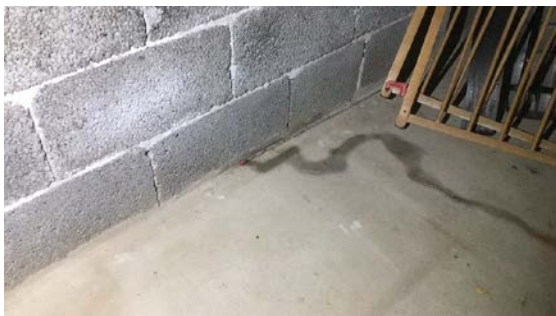
Renner vann ut under grunnmur
