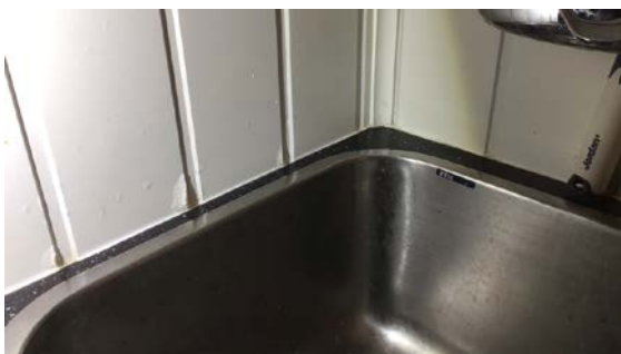
Fukt skader i plater ved vask
