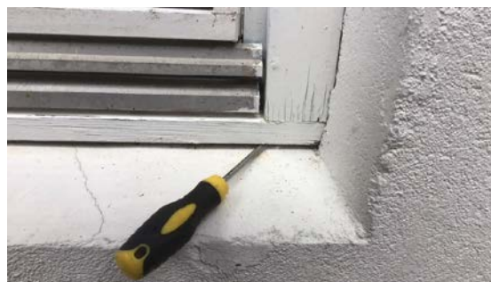
utettheter rundt kjellervinduer
