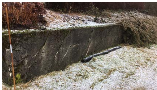
Sprekker/skader i mur
