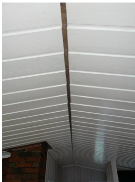
Panelbord går fra hverandre grunnet setninger.
