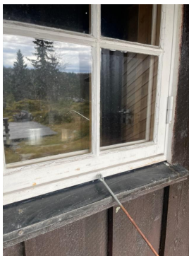
Utvendig sprekker i kitt og treverk
