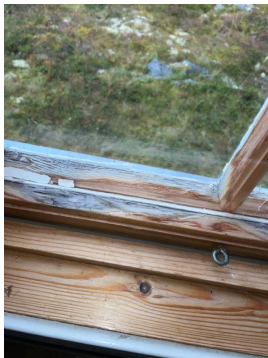
Tegn på innvendig kondensering
