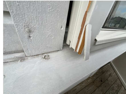
Liten skade på det ene vinduet.
