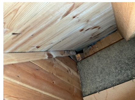
Lufting tettet igjen og lite isolasjon i taket.
