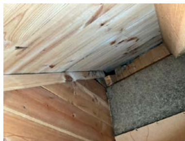
Lufting tettet igjen og lite isolasjon i taket.
