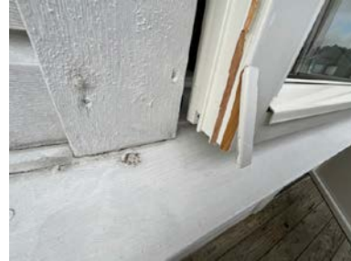
Liten skade på det ene vinduet.
