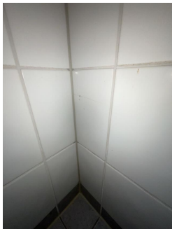
Sprukket flis i hjørne i våtsone inne i dusj. Ikke tegn til andre skader ved befaringen
