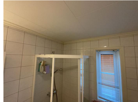
Vindu er plassert i våtsone ved dusj
