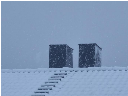
Mangler pipehatt på pipeinndekning
