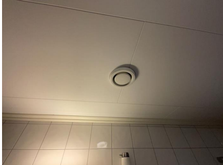
Mekanisk avtrekk i himling.
