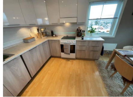
1. etasje Plassering av laser ved kontroll av kjøkken. Det er målt 7 mm høydeforskjell gjennom rommet. TG 1
