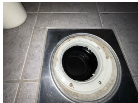
Sluk i dusj hvor membran er synlig klemt under klemring. Bilde viser sluk uten slukpotte.
