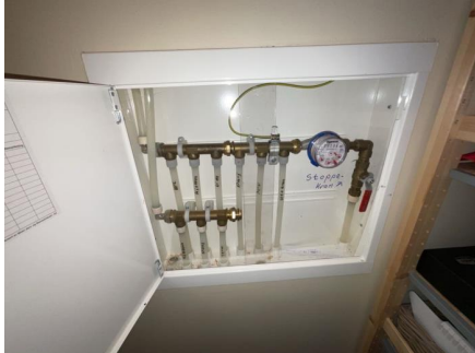
Vannfordelingskap med stoppekrane og vannmåler
