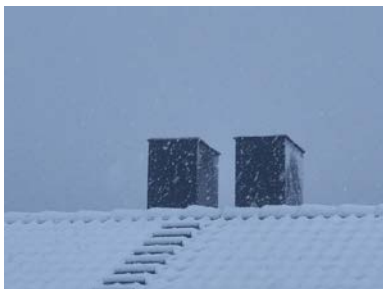
Mangler pipehatt på pipeinndekning
