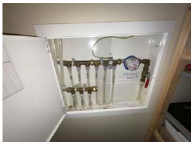
Vannfordelingsskap med stoppekrane og vannmåler
