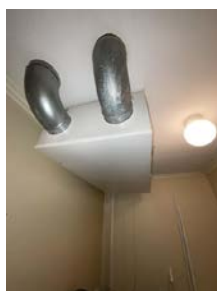
Ventilasjonsaggregat er plassert i himling på teknisk rom
