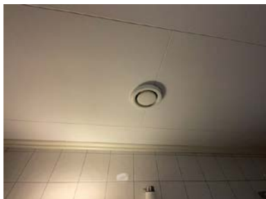
Mekanisk avtrekk i himling.
