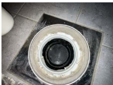
Sluk under servant hvor membran er synlig klemt under klemring. Bilde viser sluk uten slukpotte.
