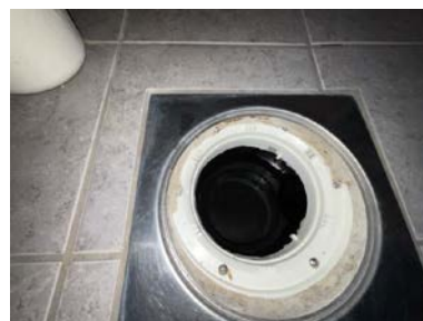
Sluk i dusj hvor membran er synlig klemt under klemring. Bilde viser sluk uten slukpotte.
