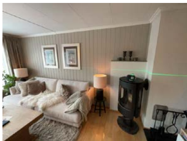
1. etasje Plassering av laser ved kontroll av stue. Det er målt 7 mm høydeforskjell gjennom rommet. TG 1
