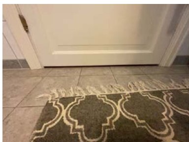
Luftespalte under dør
