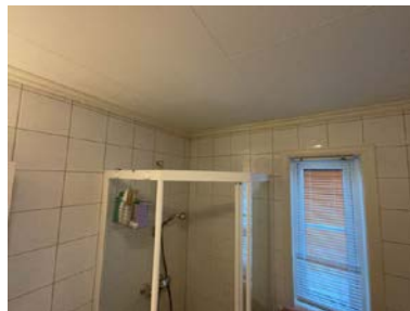
Vindu er plassert i våtsone ved dusj
