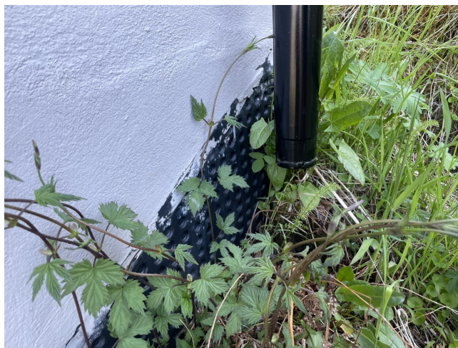
Nedløpsrørene er ikke riktig montert.
