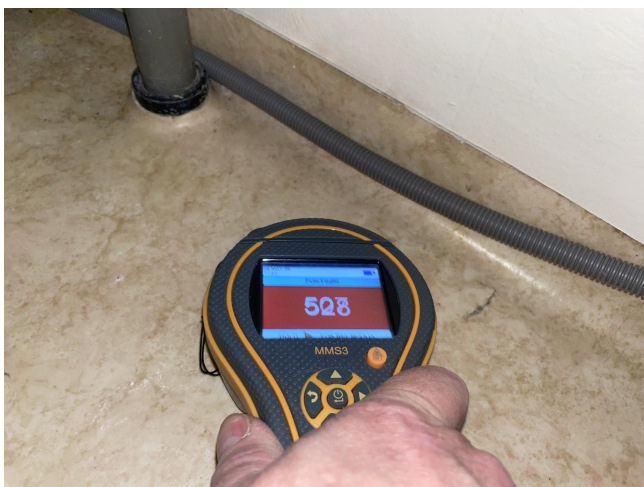
Gjennomføringer i våtsone gulv er ikke korrekt utført. Det er registrert forhøyet fuktverdi i konstruksjonen.
