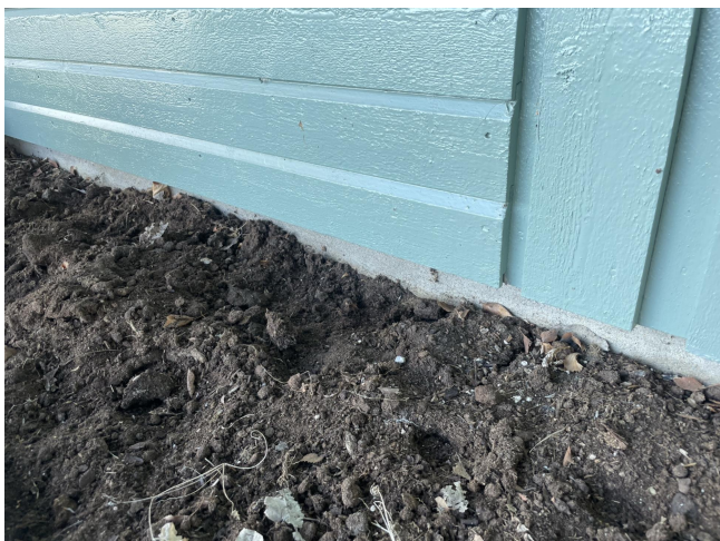
Kledning ligger for nært terreng.
