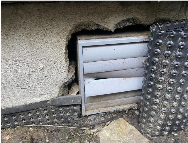
Gjennomføringer i murkonstruksjon er ikke tilfredsstillende.
