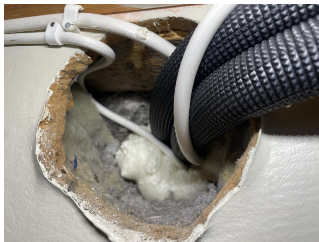
Det er registrert mindre skader på overflater, som hull, bulker og løs tapet.
