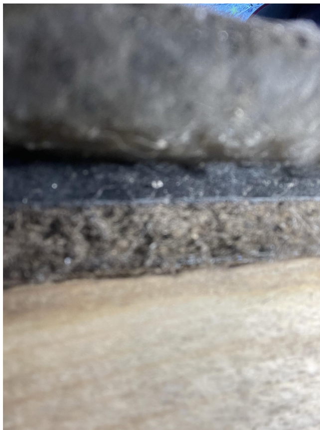
Dårlig lufting bak kledning.
