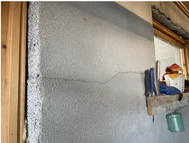
Det er riss i pussoverflaten til mur.
