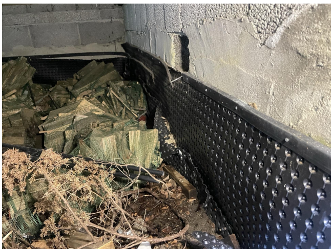
Gjennomføringer i murkonstruksjon er ikke tilfredsstillende.
