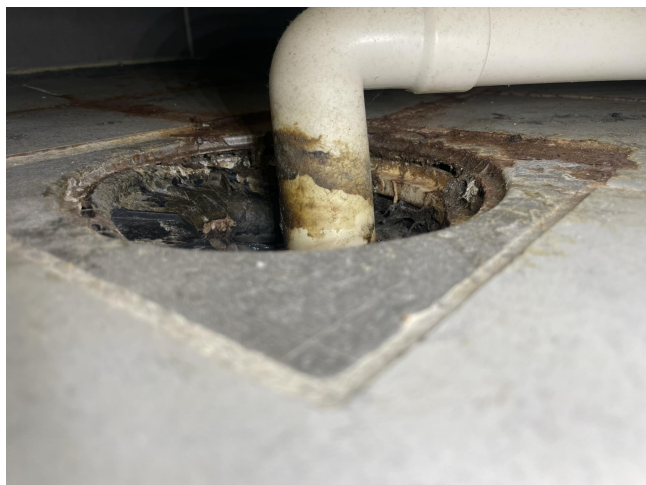
Membran kan ikke påvises i sluk eller dokumentasjon.
