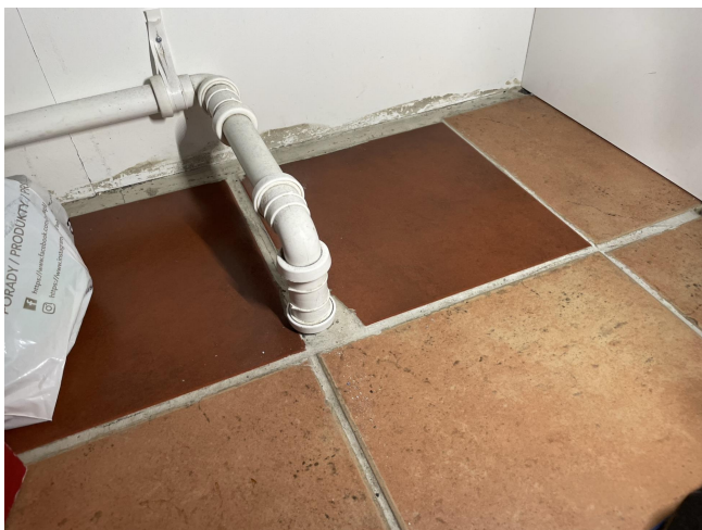
Feil utførte gjennomføringer i våtsonegulv
