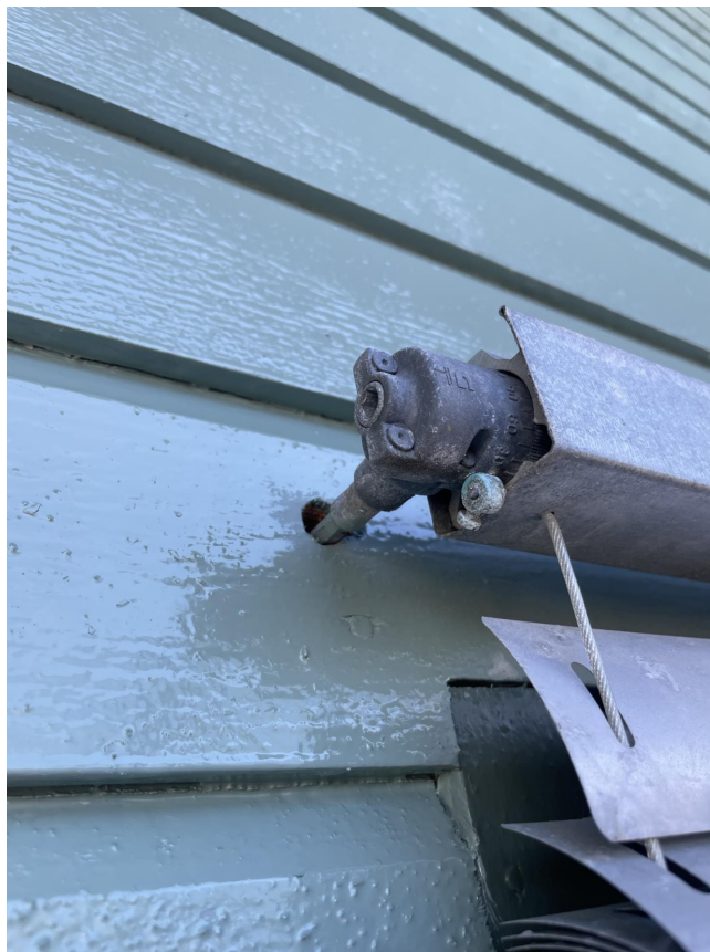
Brudd i kontinuerlig tettesjikt ved gjennomføringer (rør, kabler, ventiler).
