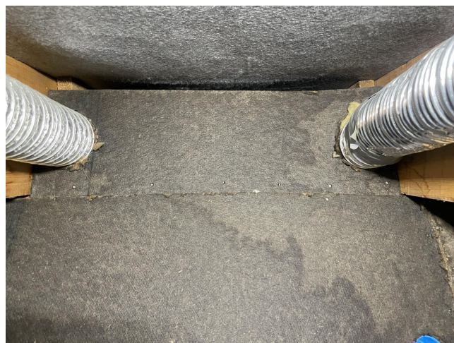
Det er påvist fuktskjolder på vegg i mørkeloft.
