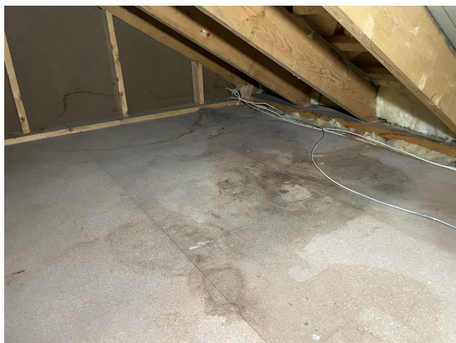
Det er påvist fuktskjolder på gulv i mørkeloft.
