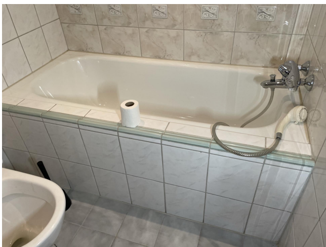
Ingen inspeksjonsluke eller tilgang til sluk under badekar.
