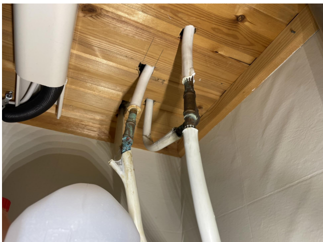
Det er registrert irr på kobberrør.
