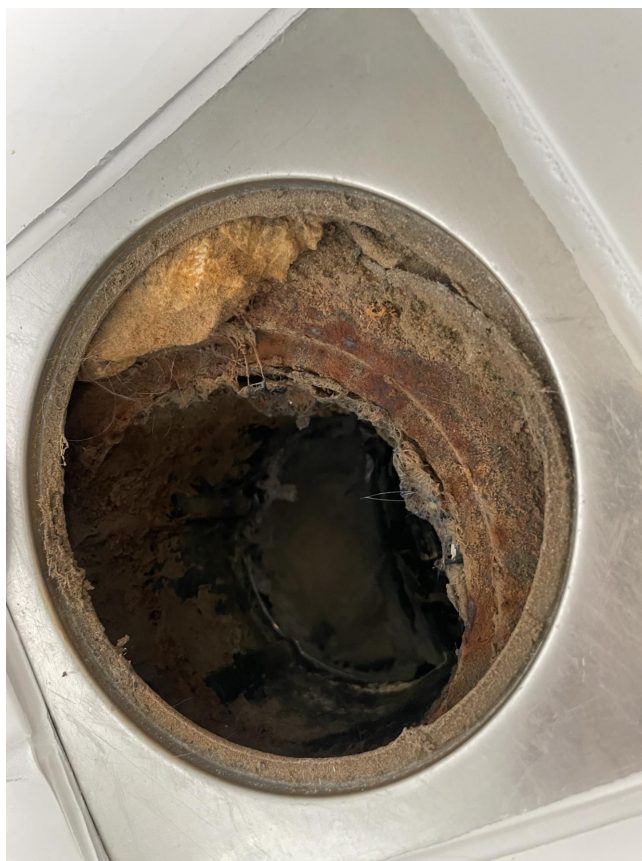
Sluk og rist ligger sideforskjøvet fra hverandre. Membran kan ikke påvises i sluk eller dokumentasjon.
