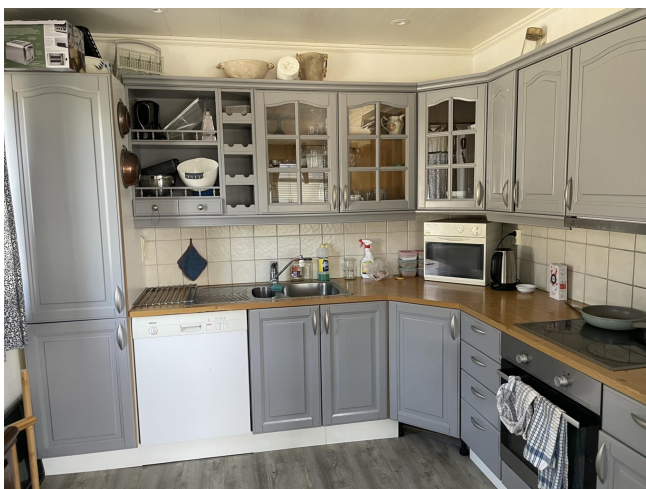
Skader på benkeplate. Nedslitte skapdører. Nedslitte skufferfronter.
