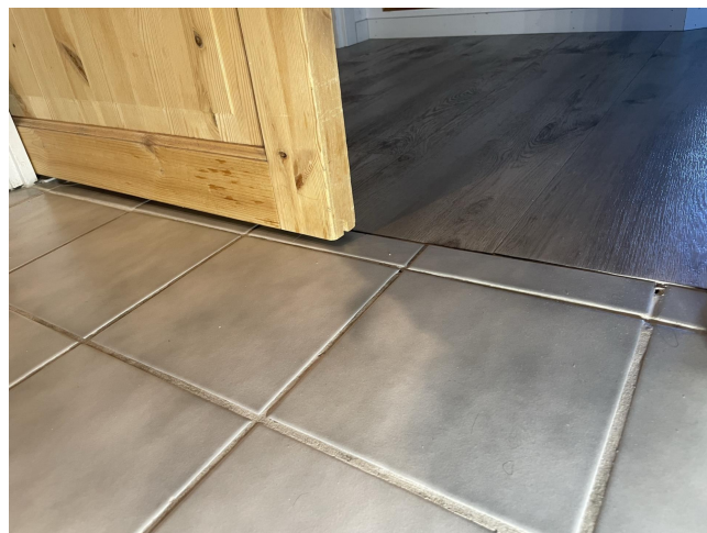
Manglende oppkant ved dør for lekkasjevann.
