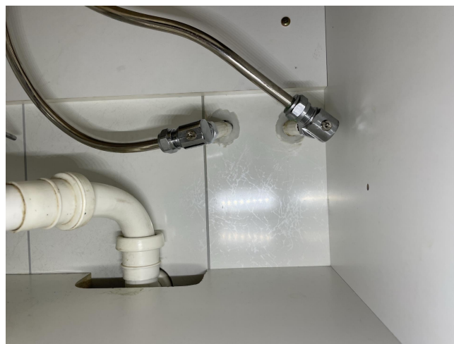
Feil utførte gjennomføringer i våtsone.
