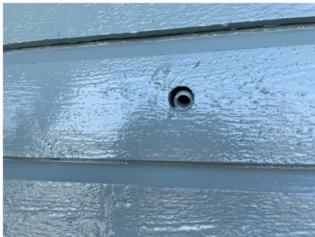
Brudd i kontinuerlig tettesjikt ved gjennomføringer (rør, kabler, ventiler).
