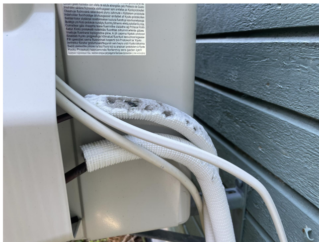
Det er registrert mindre skader på isolasjonen på rør til varmepumper.
