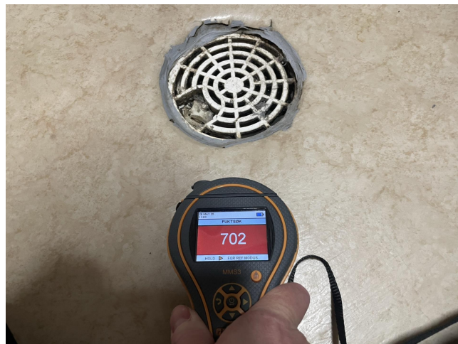
Det er registrert forhøyet fuktverdi i konstruksjonen.
