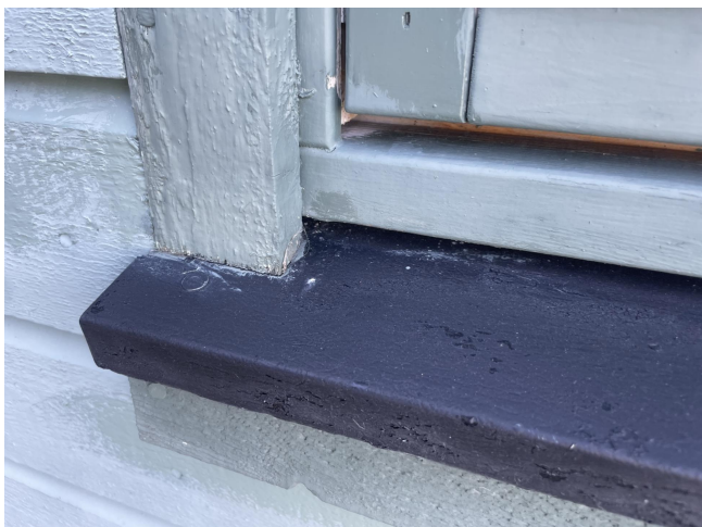
Manglende klaring mellom sidebord og beslag.
