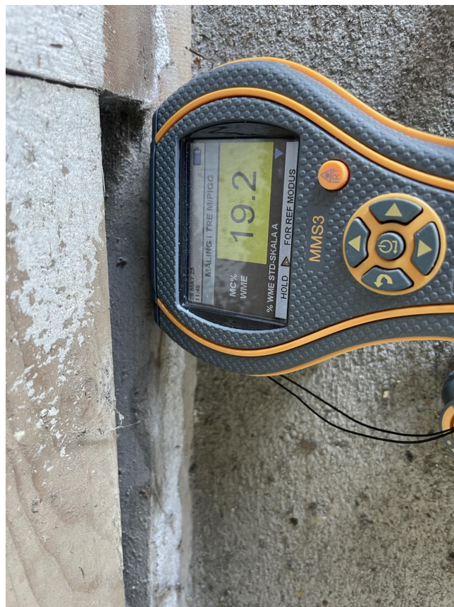
Det er registrert fuktskjolder på trevegg mot boenhet.
