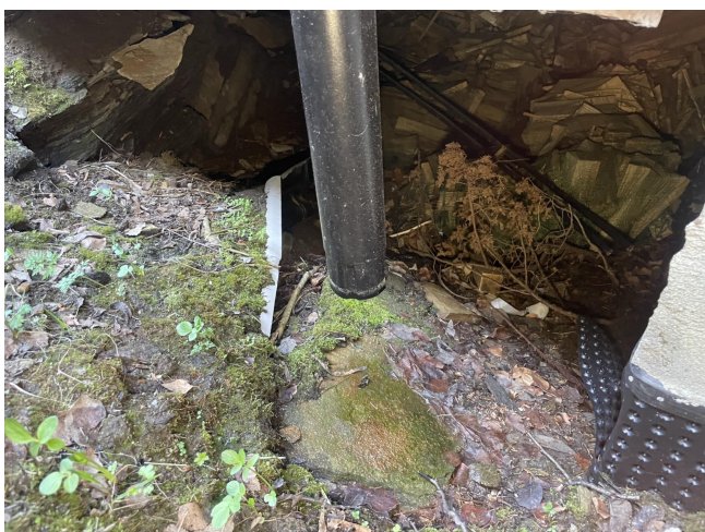
Nedløpsrørene er ikke riktig montert.
