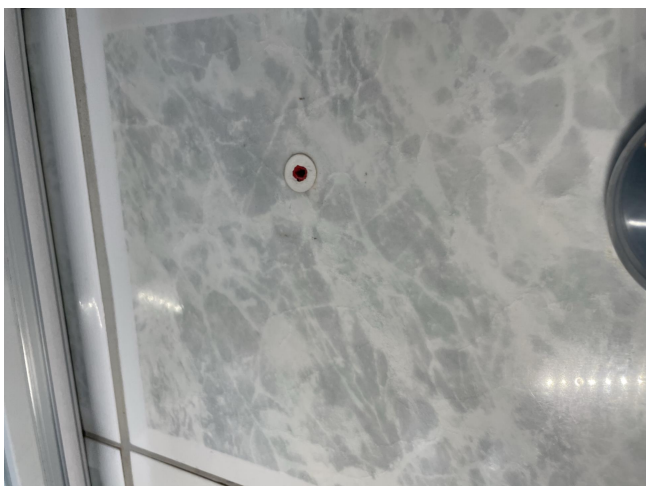
Hull etter tidligere installasjon i dusjens våtsone er ikke tett.
