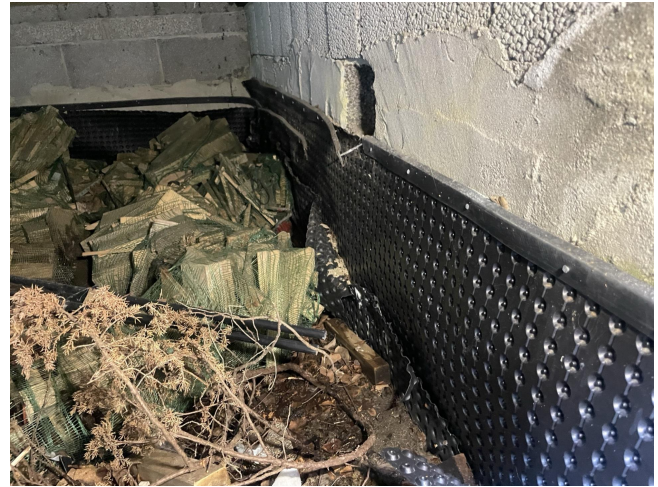
Manglende puss på Leca-konstruksjon. Gjennomføringer i murkonstruksjon er ikke tilfredsstillende.
