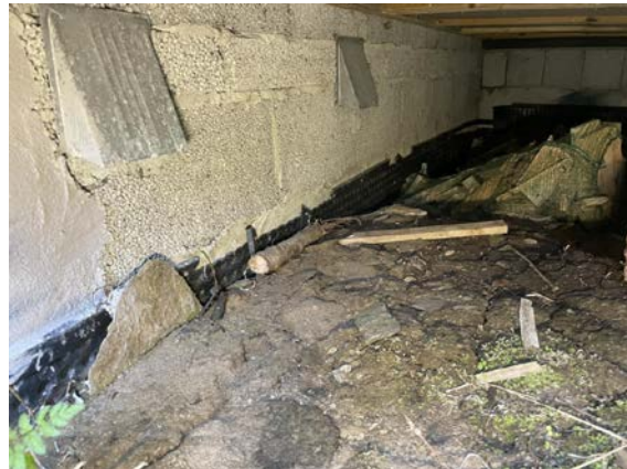
Det er motfall på terrenget, altså fall inn mot bygningen.
