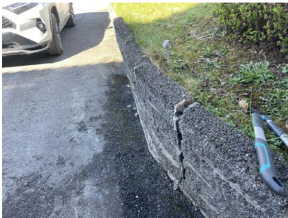
Muren er høyere enn 0,5 meter, men mangler rekkverk eller gjerde.
