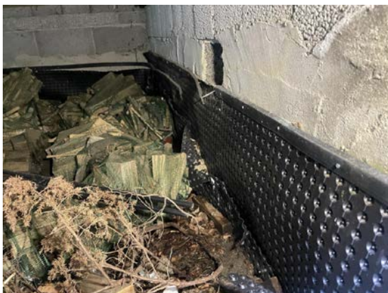
Gjennomføringer i murkonstruksjon er ikke tilfredsstillende.
