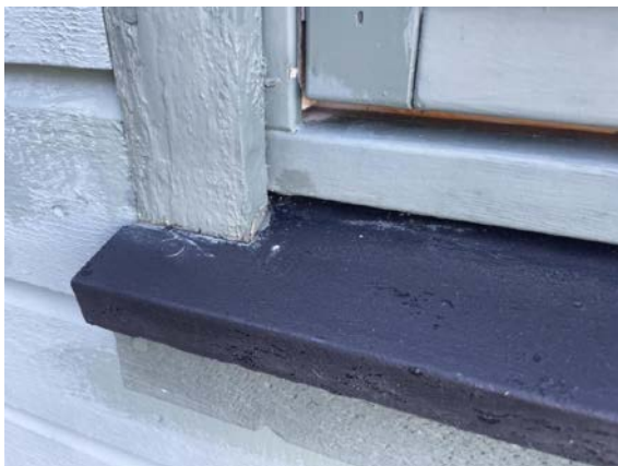
Manglende klaring mellom sidebord og beslag.
