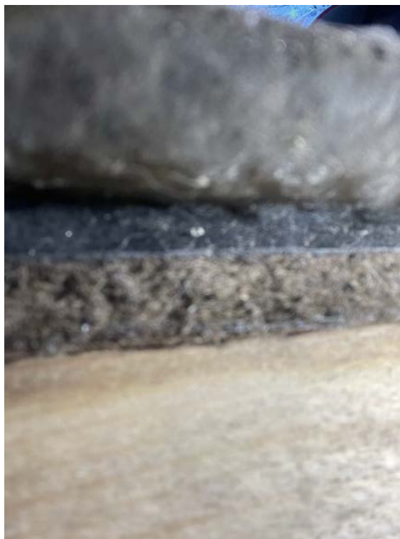
Dårlig lufting bak kledning.
