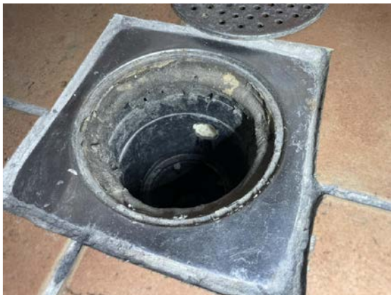
Membran ligger skjult og kan ikke kontrolleres Ingen dokumentasjon på fagmessig utførelse
