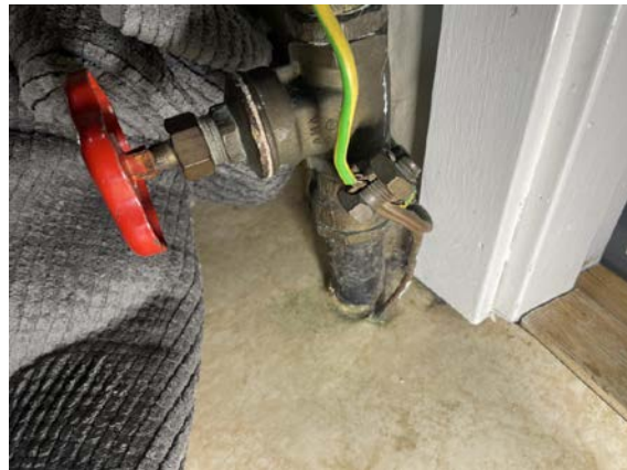
Eldre stoppekran med skrukobling er registrert. Stoppekransen viser tegn til slitasje og alder.
