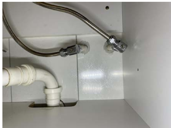
Feil utførte gjennomføringer i våtsone.
