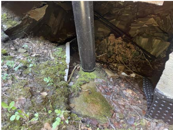
Nedløpsrørene er ikke riktig montert.
