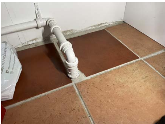
Feil utførte gjennomføringer i våtsonegulv
