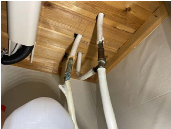
Det er registrert irr på kobberør.
