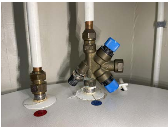
Det er registrert irr på koblinger.
