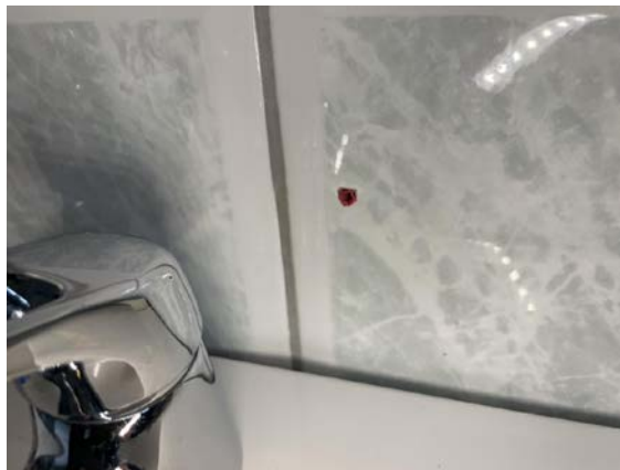
Hull etter tidligere installasjon i våtsone er ikke tettet.
