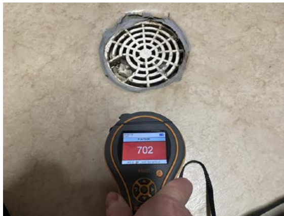
Det er registrert forhøyet fuktverdi i konstruksjonen.
