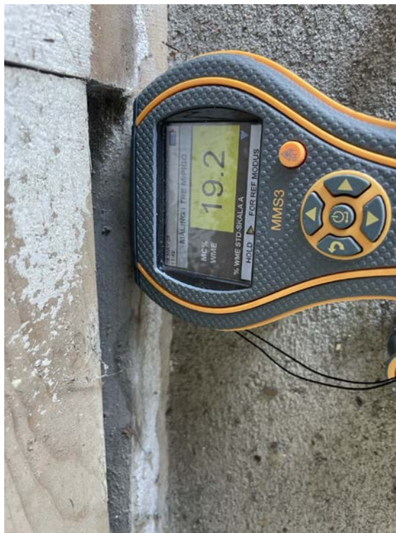
Det er registrert fuktskjolder på trevegg mot boenhet. Målt fuktinnhold i treverket er 19,4 %, noe som er over anbefalt grenseverdi for tørt treverk.
