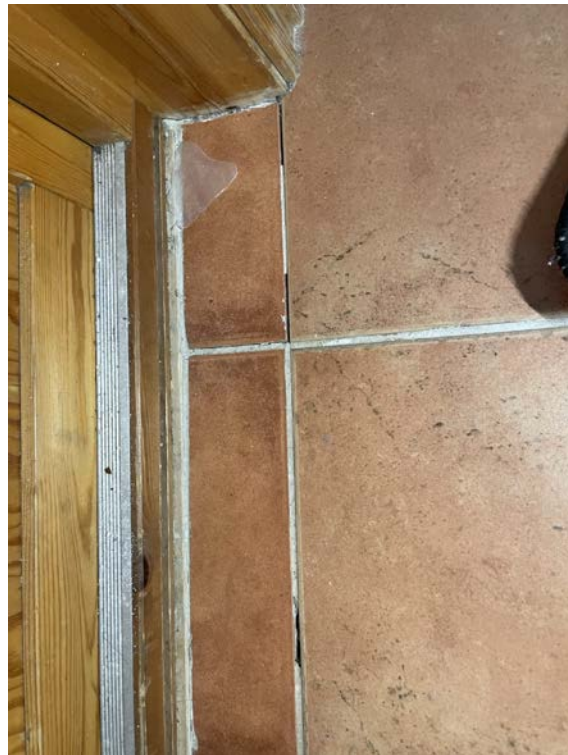
Manglende feielist Manglende fuger Løse fliser Bom registrert (hulrom under fliser)
