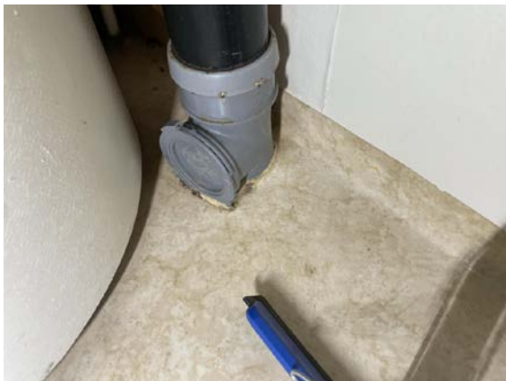
Det er registrert mindre skader på overflater. Gjennomføringer i våtsone gulv er ikke korrekt utført.
