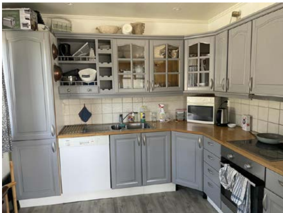
Skader på benkeplate. Nedslitte skapdører. Nedslitte skufferfronter.
