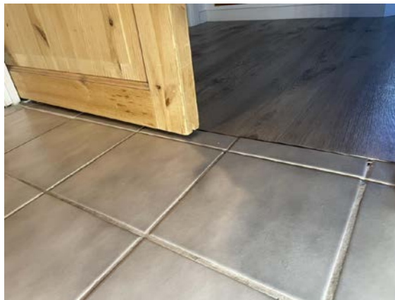
Manglende oppkant ved dør for lekkasjevann.
