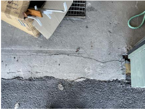
Det er registrert sprekker og riss i betonggulvet.
