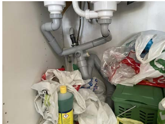
Løse deler og motfall på avløpsvann fra sidekum.
