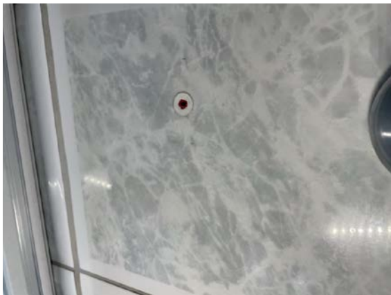
Hull etter tidligere installasjon i dusjens våtsone er ikke tettet.
