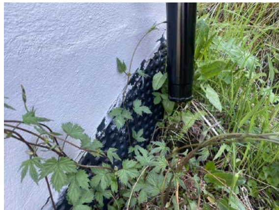
Nedløpsrørene er ikke riktig montert.
