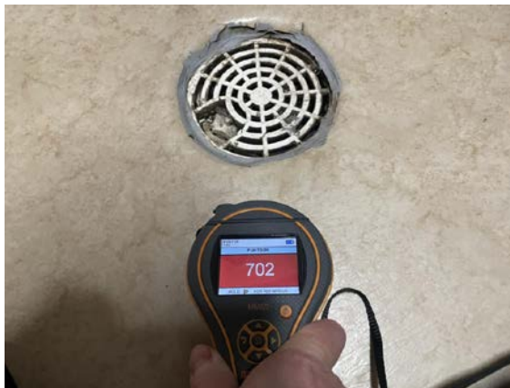
Det er registrert forhøyet fuktverdi i konstruksjonen.
