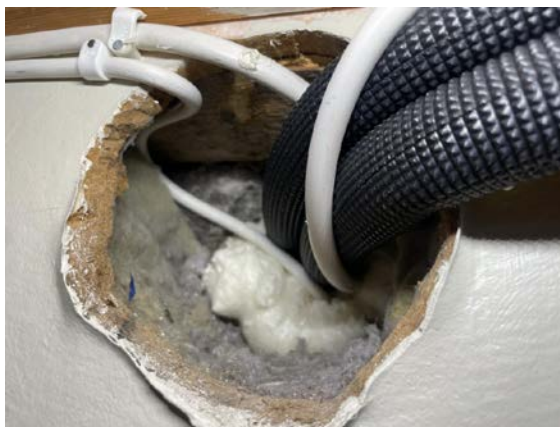
Det er registrert mindre skader på overflater, som hull, bulker og løs tapet.
