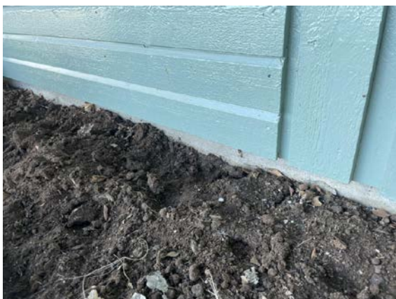
Kledning ligger for nært terreng.
