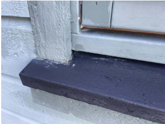
Manglende klaring mellom sidebord og beslag.
