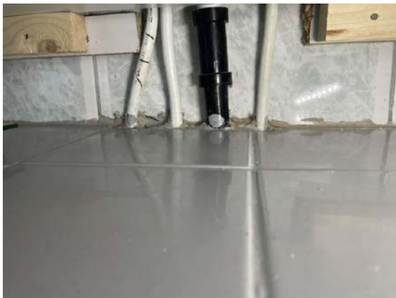
Gjennomføringer i våtsone på gulv er ikke korrekt utført.
