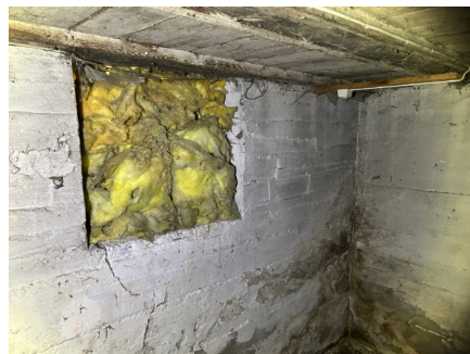
Grunnmuren har sprekke-dannelser.
