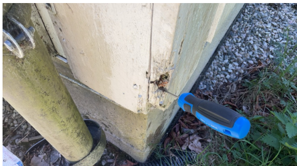
Det er påvist spredte råteskader i bordkledningen.
