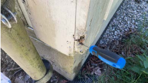
Det er påvist spredte råteskader i bordkledningen.
