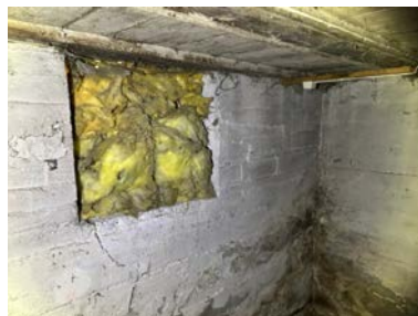
Grunnmuren har sprekkdannelser.
