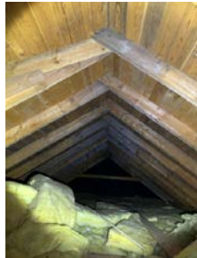
Det er begrenset/dårlig ventilering av takkonstruksjonen.
