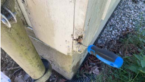
Det er påvist spredte råteskader i bordkledningen.
