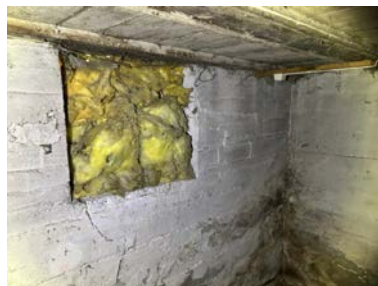
Grunnmuren har sprekkdannelser.
