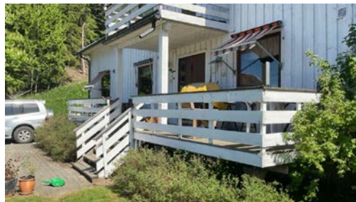
Rekkverket er for lavt i forhold til dagens krav til rekkverkshøyder. Åpninger i rekkverk er ikke i henhold til krav i dagens forskrifter.
