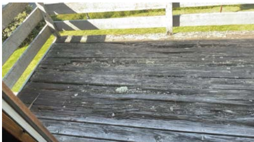
Det er påvist råteskader i konstruksjonen på terrasse i 2. etasje.
