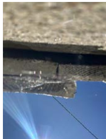
Det er ingen eller liten lufting i nedre kant av kledning mot grunnmur.
