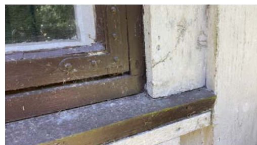
Vindusomramming står i kontakt med underbeslaget og trekker dermed opp fukt/vann som reduserer levetiden på sidebordene.
