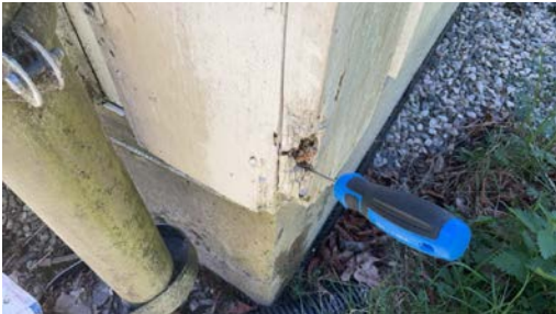
Det er påvist spredte råteskader i bordkledningen.
