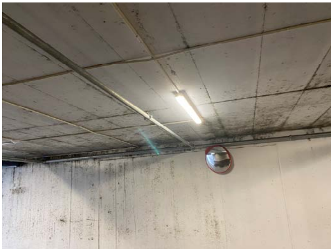
Bilde 2 Misfarging/sopp pga kondensering i betonghimling v/kjøreport
