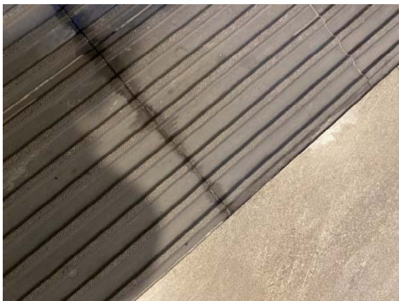
Bilde 5 Fukt i fuge på taktillflis
