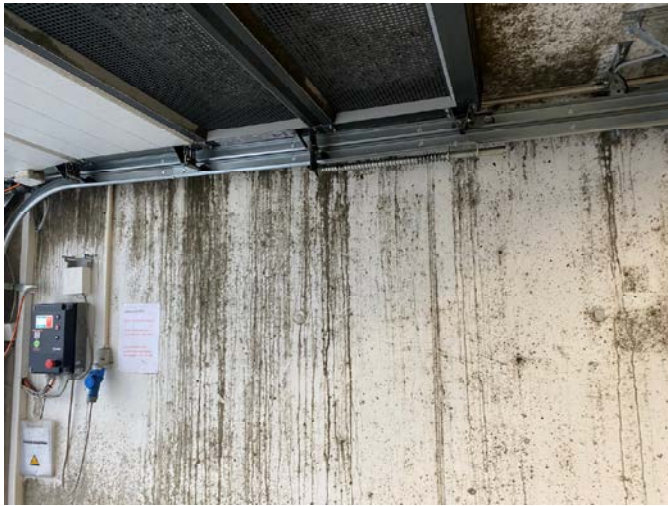
Bilde 1 v/kjøreport Misfarigning/ sopp pga kondensering
