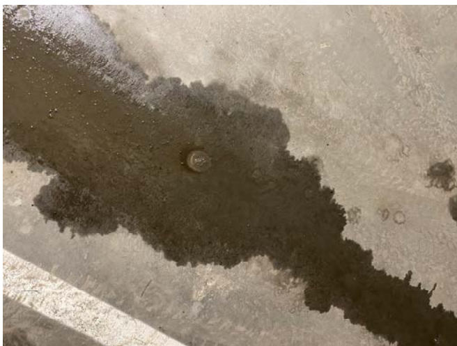
Bilde 3 Fuktførende gjennomgående riss. Bildet tatt 22.12.23 ved kraftig springflo.
