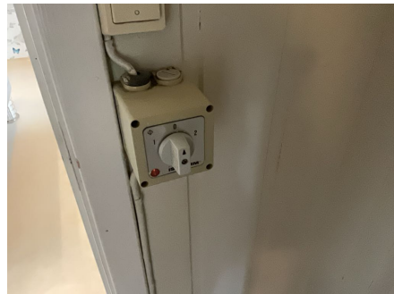
Varmekabel tmellom bolig og vannpumpe.
