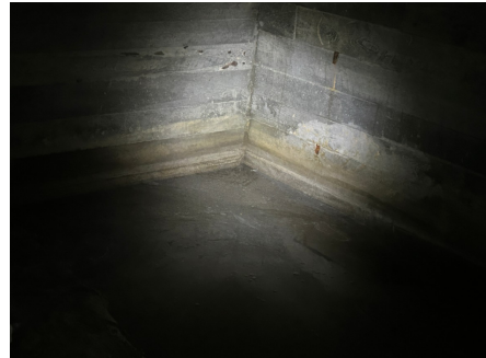
Stående vann i krypkjeller.
