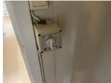
Varmekabel mellom bolig og vannpumpe.
