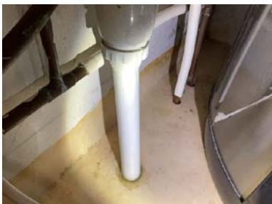
Utilfredstillende tetting ved rørgjennomganger
