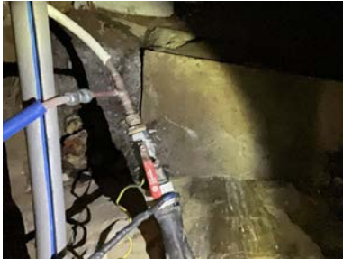
Stoppekran er plassert i krypkjeller.
