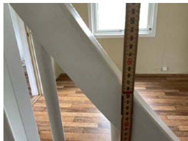
Rekkverkshøyder er under dagens forskriftskrav til rekkverk i trapper.
