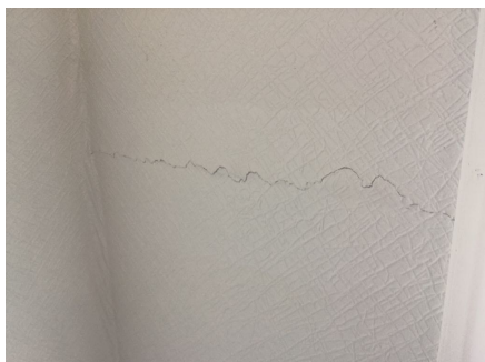
Eksempel på riss i tapet.
