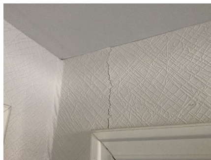
Eksempel på riss i tapet og tapet som folder seg i vegg hjørne.
