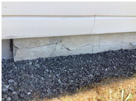
Eksempel på sprekk i grunnmur.
