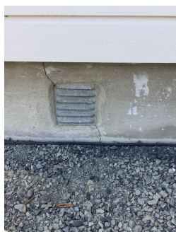
Eksempel på sprekk i grunnmur.
