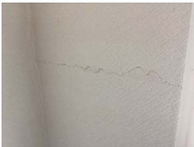
Eksempel på riss i tapet.
