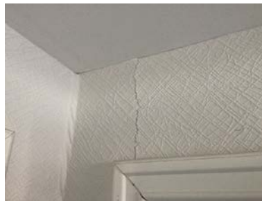
Eksempel på riss i tapet og tapet som folder seg i veggjørner.
