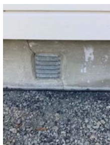
Eksempel på sprekk i grunnmur.
