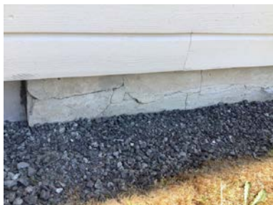
Eksempel på sprekk i grunnmur.
