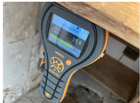
Det måles høye fuktverdier i treverk i kryperom på kjøkken.
