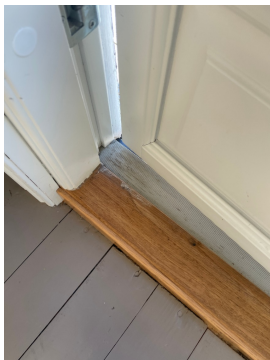
Terrassedør supper i terskel og glipper mot karm i topp.
