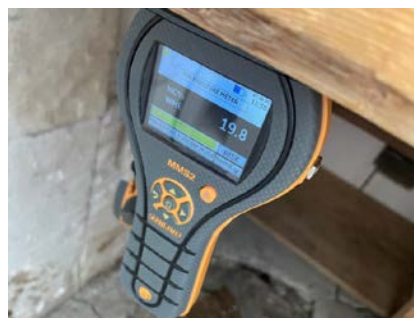
Det måles høye fuktverdier i treverk i kryperom på kjøkken.
