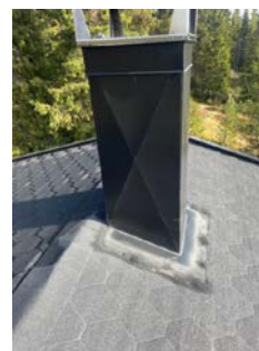
Stedvis sprekker i tettemiddel mellom papp og beslag.
