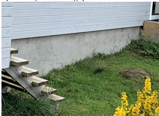
Område uten tilstrekkelig fall fra bygningen
