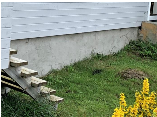
Ventiler med svak eller ingen funksjon
