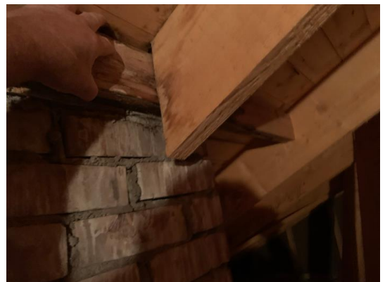
Kaldtloft. kontroll av eldre fuktskade
