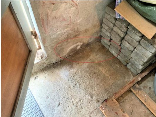
Fuktig mur og gulv i kjellerdel, med saltutslag
