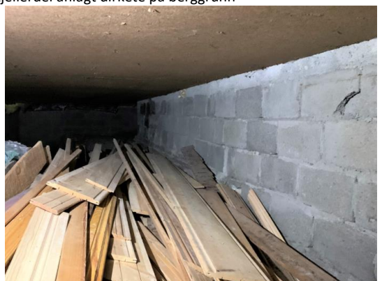
Krypkjellerdel med svak eller ingen ventilfunksjon
