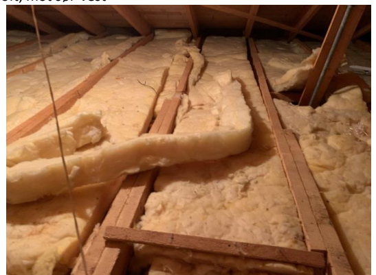
Kaldtloft, ufagmessig og uheldig montering av mineralull
