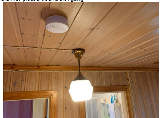
Røykvarsler plassert sentralt i gang
