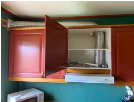
ventilator med avtrekk ut i ventil i vegg Årstall: 1998 Kilde: Eier
