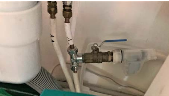
Ledninger i kjøkken Årstall: 1987 Kilde: Andre opplysninger: Bygningssakskyndigs vurdering av forholdene og alder på synlige ledningsdeler/vv-tank.
