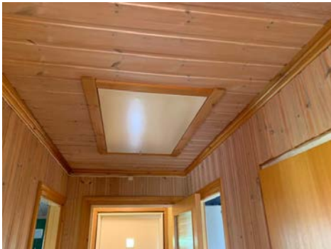
Nedtrekkbar stige som adkomst til kaldtloft
