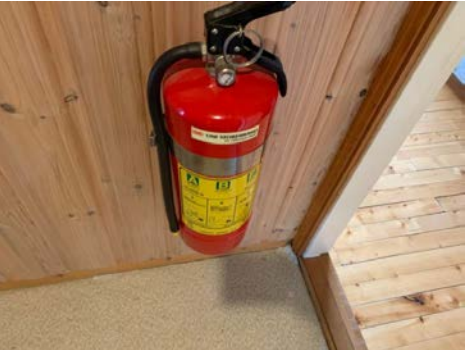
Brannslukker plassert sentralt i gang
