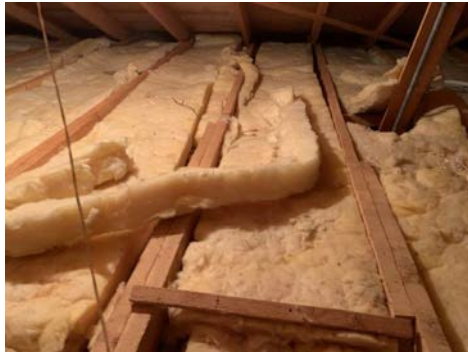
Kaldtloft, ufagmessig og uheldig montering av mineralull
