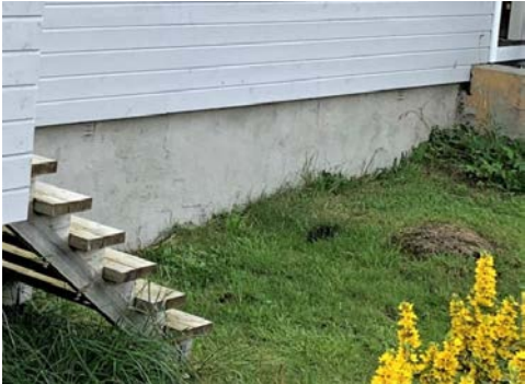
Område uten tilstrekkelig fall fra bygningen
