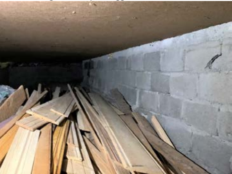
Krypkjellerdel med svak eller ingen ventilfunksjon
