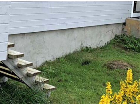
Ventiler med svak eller ingen funksjon
