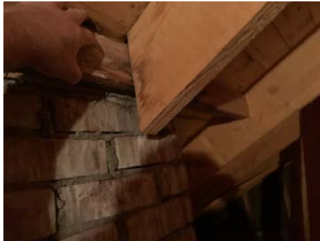
Kaldtloft. kontroll av eldre fuktskade
