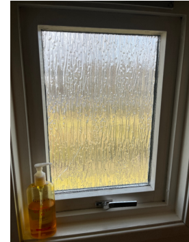
Sprekk I glass vindu bad 2.etg.
