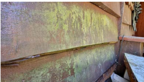
Soppvekst i ytterkledningen.
