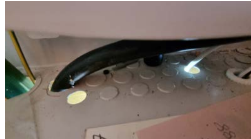
Utettete hull i el-skapet.
