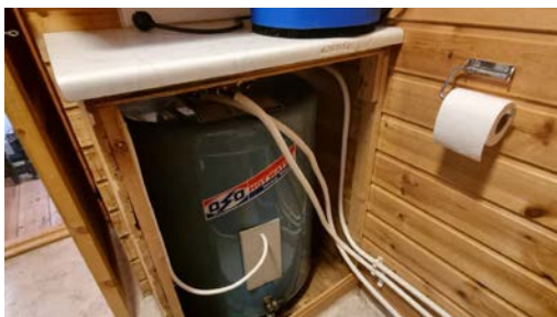
Varmtvannsbereder er plassert på bad/wc.
