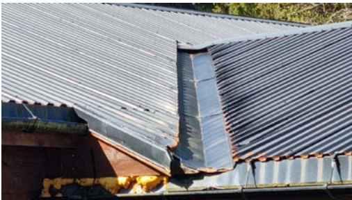
Stedvis rust og bulker i taktekket
