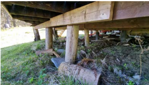
Store skjevheter i fundamenteringen på terrassen mot nordøst.
