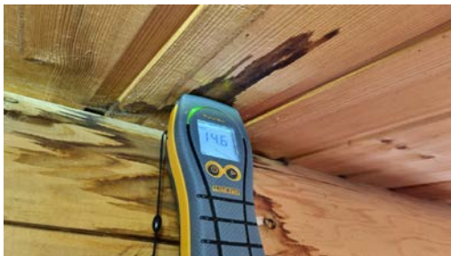
Fuktmåling i himling i stue 2, svakt forhøyede fuktverdier ble registrert
