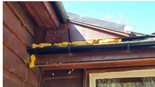
Det er ufagmessig tette med byggsaum i overgang renne og tak.
