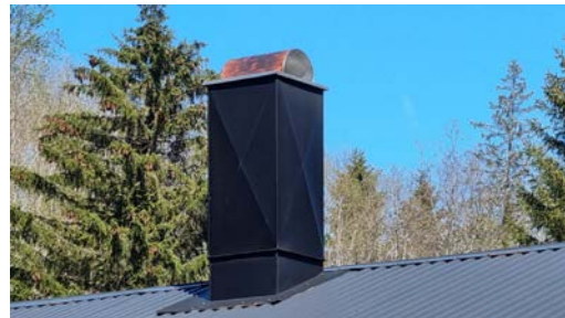
Rust i pipehatt
