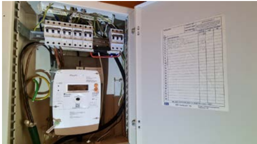
Kontroll av el-skapet.
