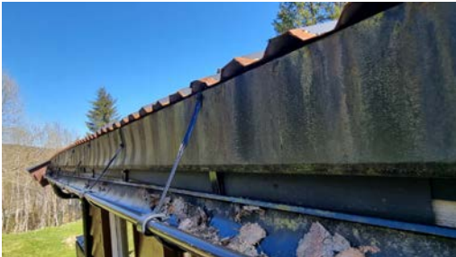
Renner er montert langt ned i forhold til taket
