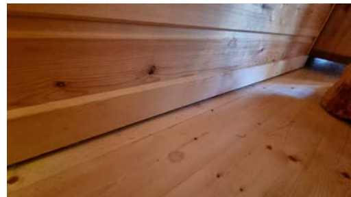
Stedvis glipper mellom gulv og gulvlister.
