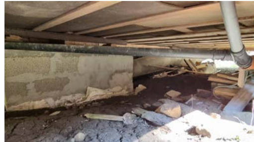
Avløpsrør under hytta
