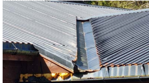
Rust og bulker i beslag
