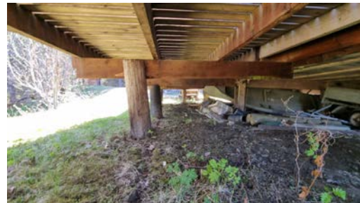
Også store skjevheter i fundamenteringen på terrassen mot sørøst. Her er også en av pilarene falt ned.
