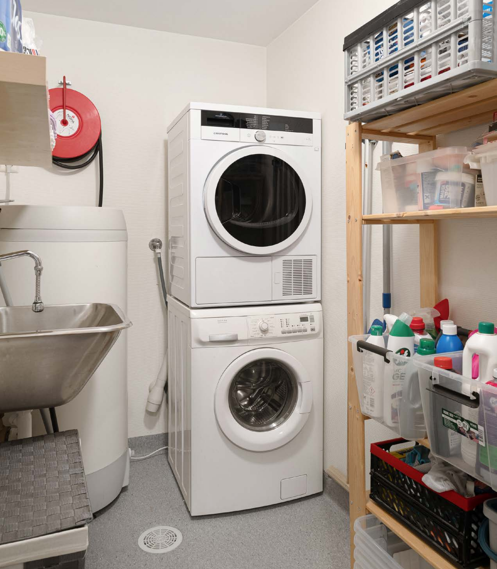
Praktisk vaskerom med utslagsvask og opplegg til vaskemaskin og tørketrommel.
