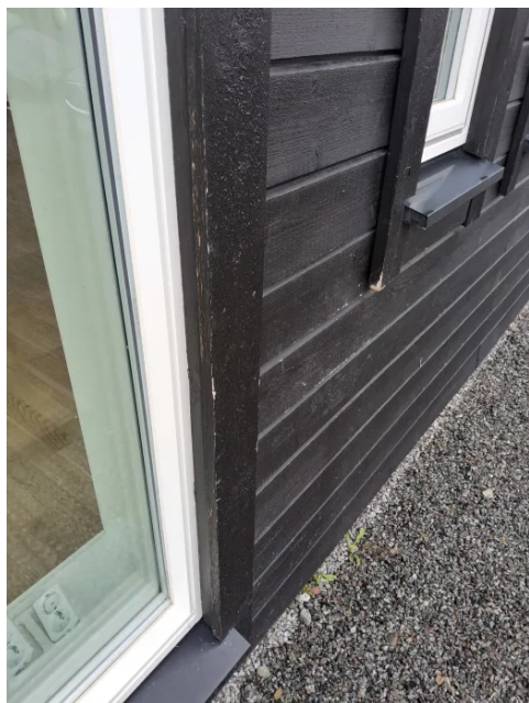
Kledningen er stedvis værslitt.
