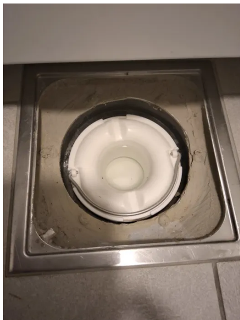
Plastsluk på vaskerommet.
