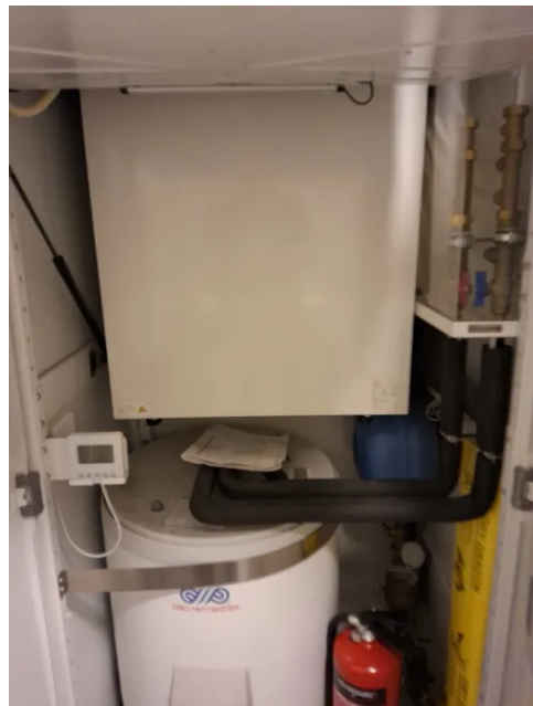
Ventilasjonsaggregat er plassert i teknisk skap.
