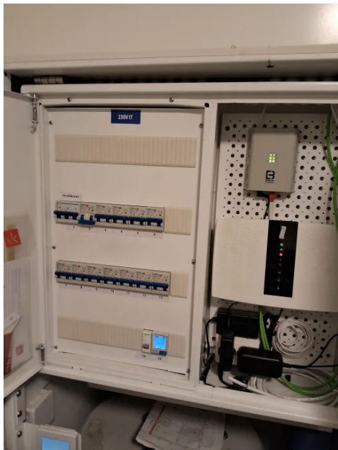
Sikringsskap med automatsikringer.
