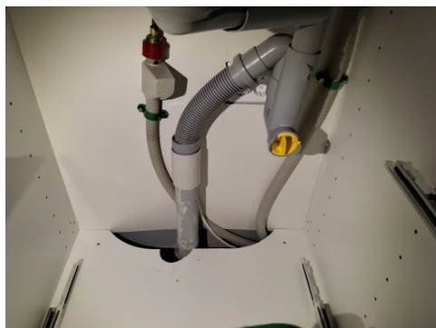
Boligen har synlige avløpsrør av plast.
