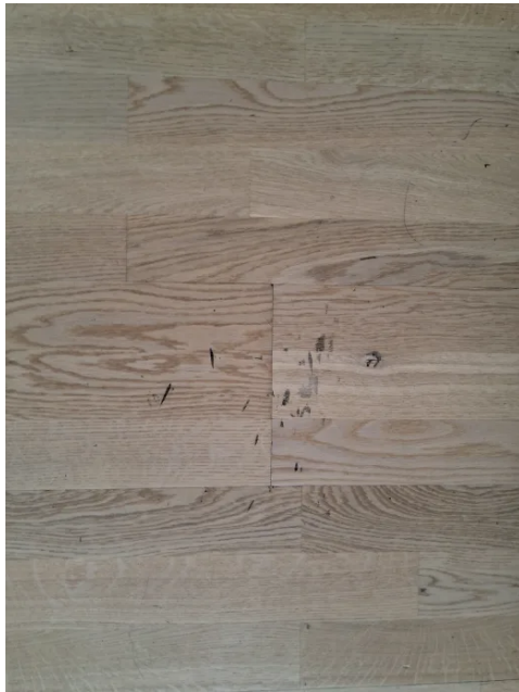
Hakk og skader i parkettgulv.
