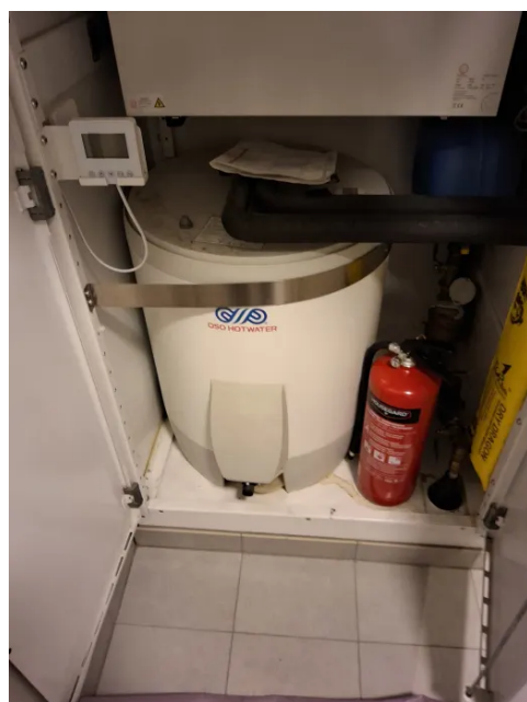
Varmtvannsbereder er plassert i teknisk skap.
