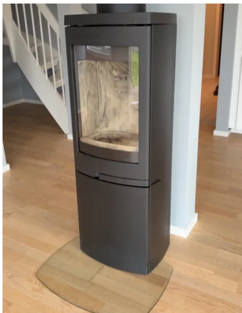
Vedovn med glassdør i stue.
